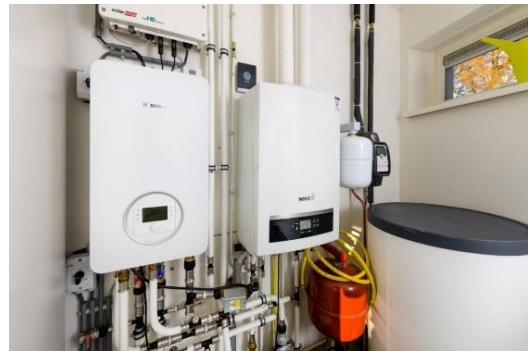
Afbeelding 5: Binnenunit hybride warmtepomp (links) naast de CV-ketel (rechts)
