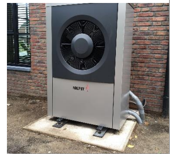
Afbeelding 2: Buitenunit bij luchtwarmtepomp
